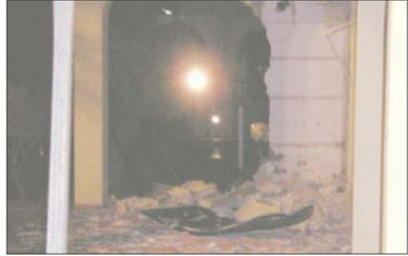
I danni all'abitazione estiva di Talarico causati dall'esplosione di una bomba
