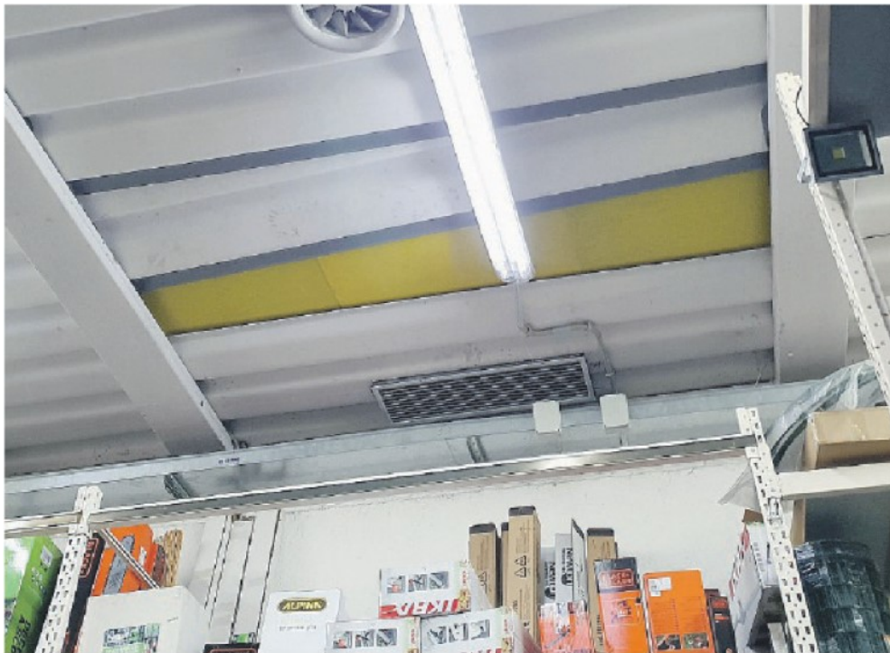
In foto sopra il controsoffitto danneggiato e a destra l'ingresso del negozio di via Epitaffio
