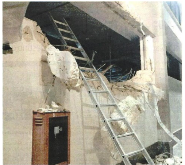
Il muro dell'Ivri distrutto. A destra, le guardie giurate sconvolte dopo l'assalto
